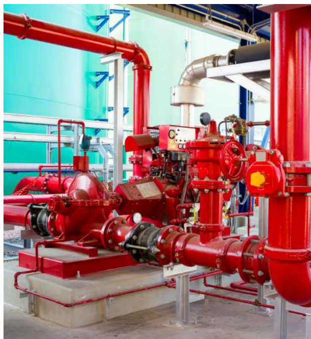
Sistema de Bombeo Diésel
