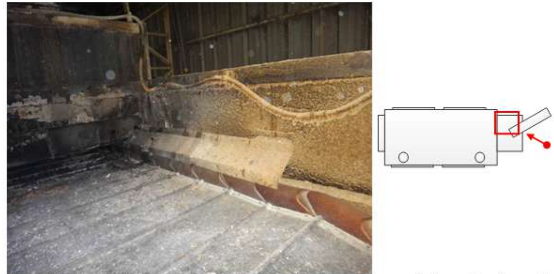
Figura 15 – Sector de ingreso de pellet al horno. Se observan acumulaciones de polvo en las inmediaciones.
