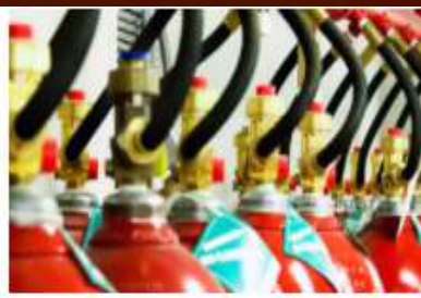
Sistemas de extinción
