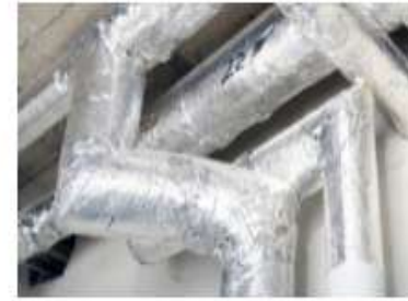
Sistemas de ductos y cables
