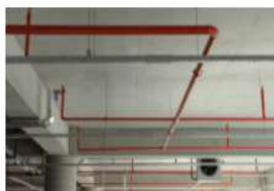
Tuberías y conexiones
