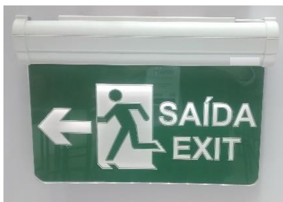
Figura 4 – Bloco Autônomo – Exemplo de Proteção Ativa
