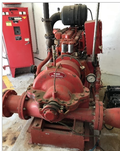
Figura 30 – Bomba Centrífuga ( in line ) com Motor à Explosão
