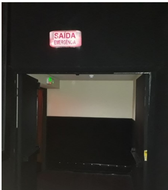
Figura 3 – Luz de Emergência indicando “SAÍDA” em sala de exibição de cinema
