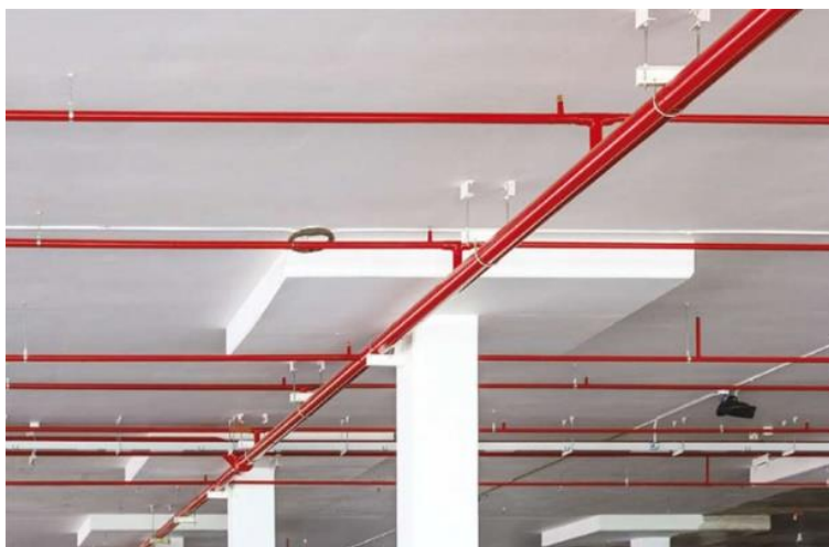
Figura 9 – Tubulação de Chuveiros Automáticos
