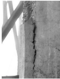
Figura 7 – Spalling em pilar de concreto
