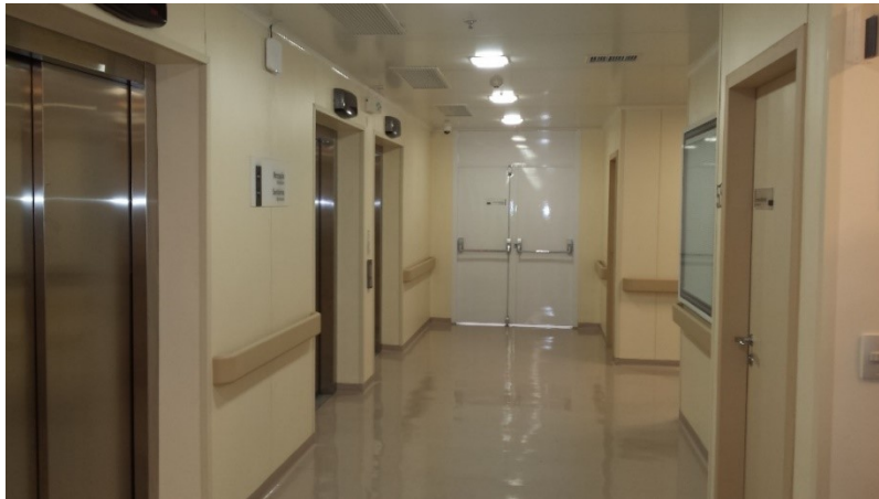
Figura 14 – Controle de Fumaça em Rotas de Fuga
