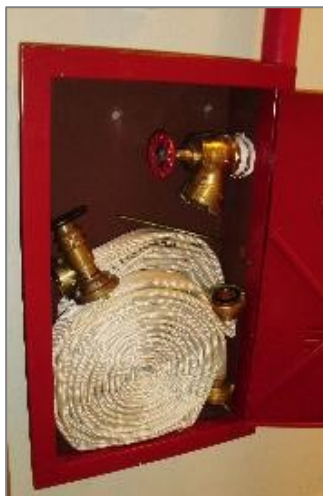
Figura 9 – Mangueira de Incêndio Aduchada
