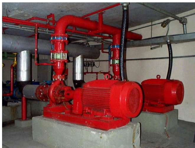
Figura 13 – Bomba de Incêndio
