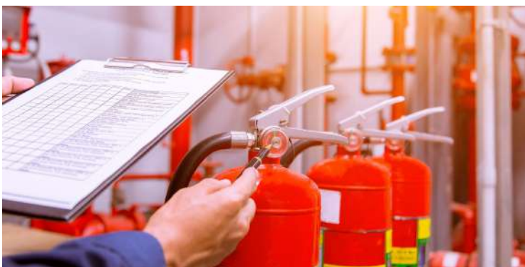
Inspección de Extintores
