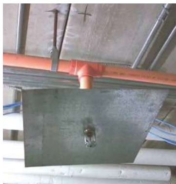
Figura 2: “Colector de Calor” en rociador iii
